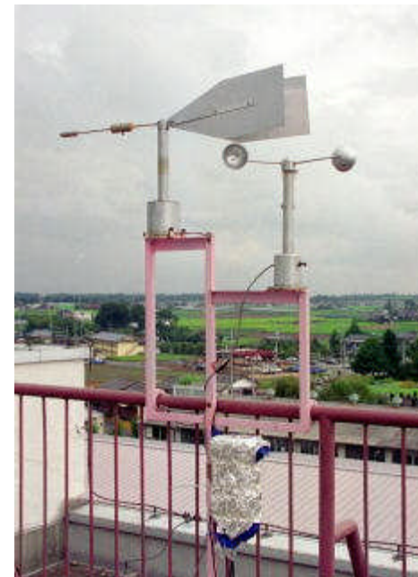
屋上に設置した風向、風力計
